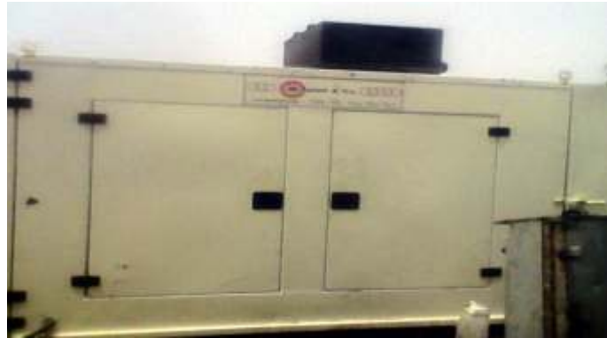
MAIGATARI KARA NEW GENSET
